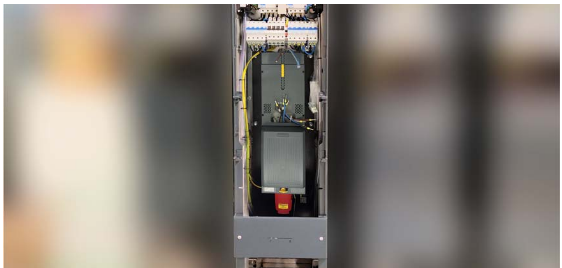
Figuur 4-5: Compartiment netbeheer (geïnstalleerd)
